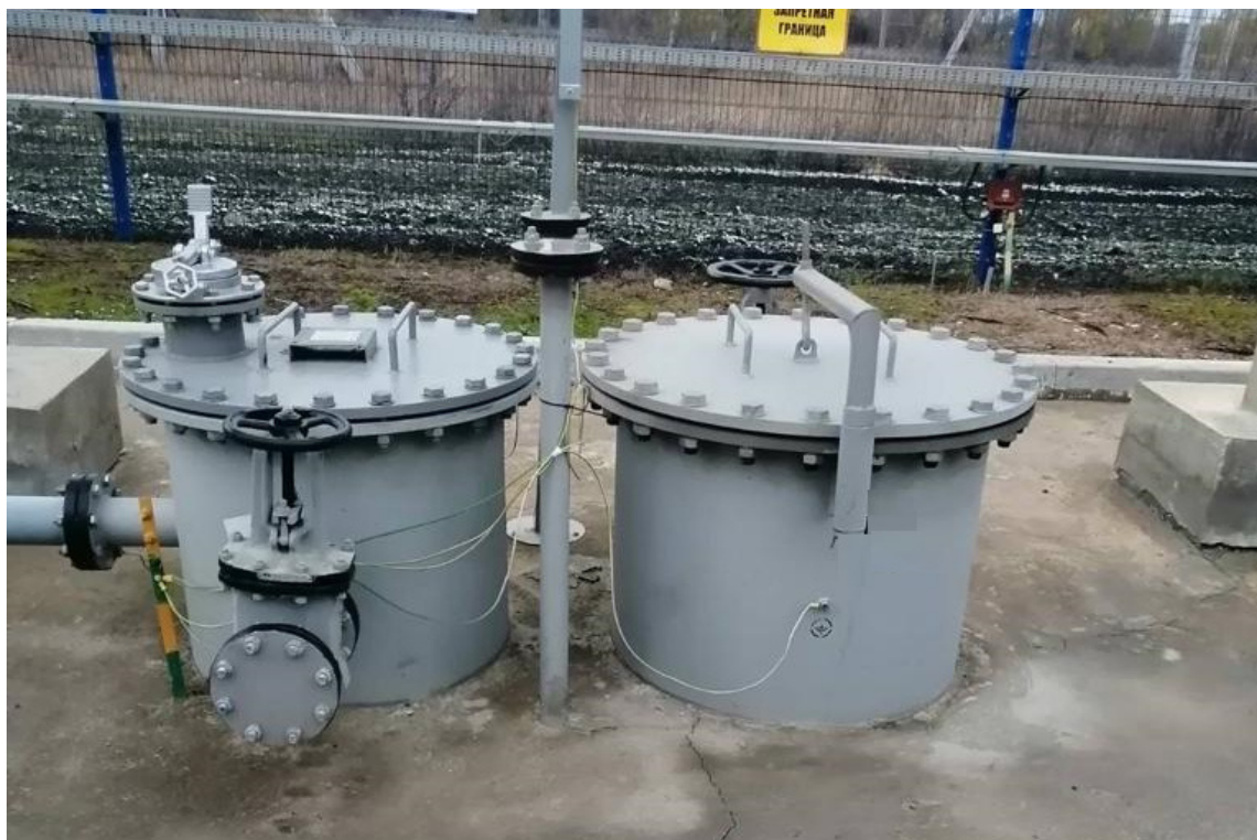
Рисунок 3 – Горловины и измерительный люк резервуара
