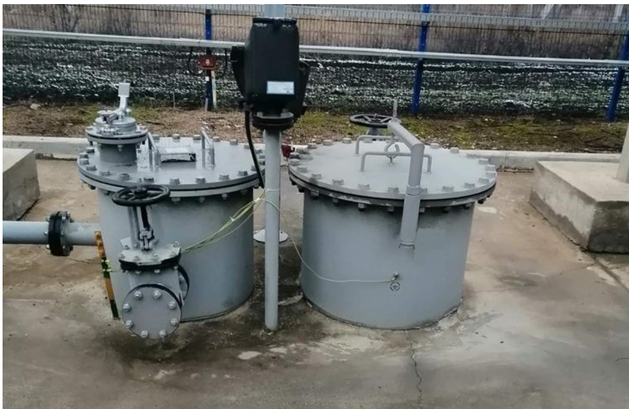
Рисунок 3 – Горловины и измерительный люк резервуара
