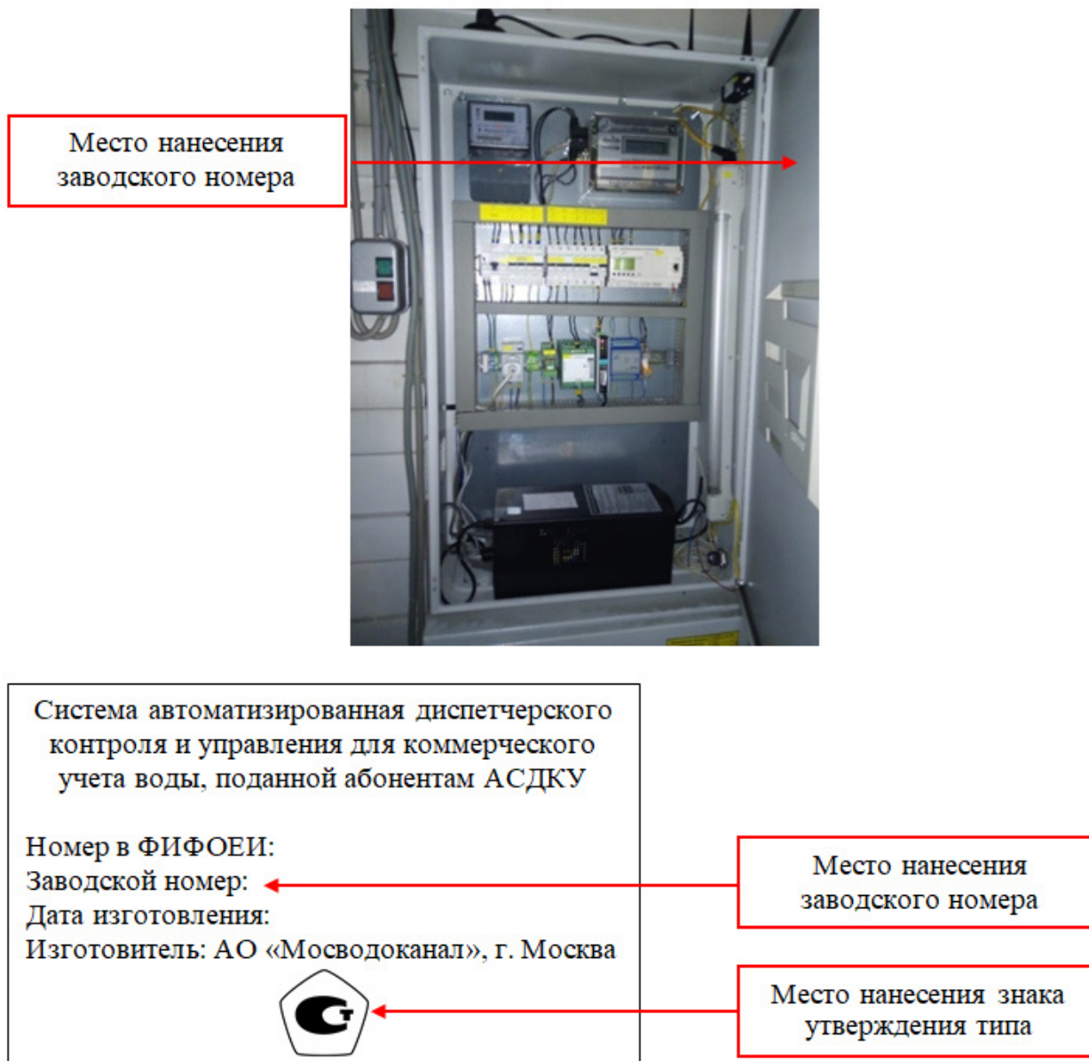
Рисунок 2 – Комплексный и связующий компоненты, установленные в шкафу сбора и передачи данных
