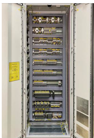
Рисунок 3 – Шкаф соединительный ( в открытом виде)
