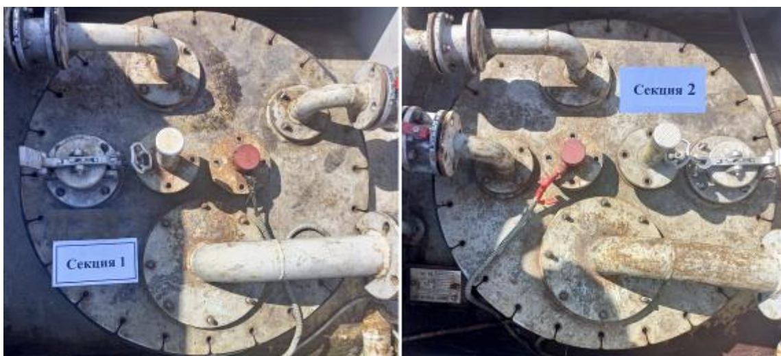
Рисунок 4 – Горловины и измерительные люки резервуара РГ 20/2-П-02-УХЛ1ТУ зав.№ 1636 Пломбирование резервуара РГ 20/2-П-02-УХЛ1ТУ не предусмотрено.
