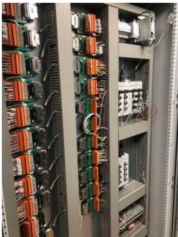
Рисунок 3 – Стойка с оборудованием для монтажа проводных линий связи
