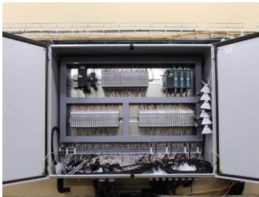
Рисунок 1 – Общий вид шкафа управления системы
