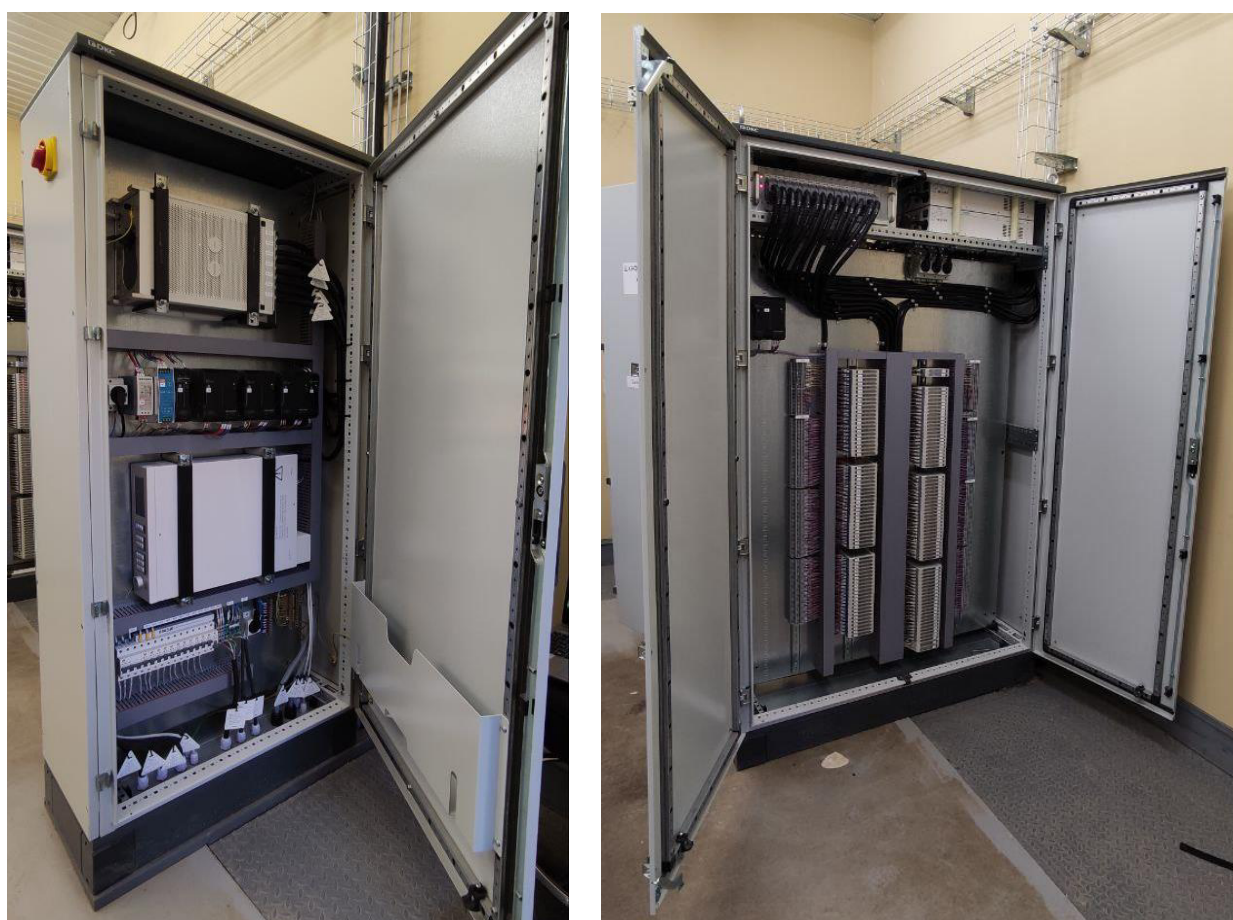
Рисунок 2 – Общий вид шкафов управления системы
