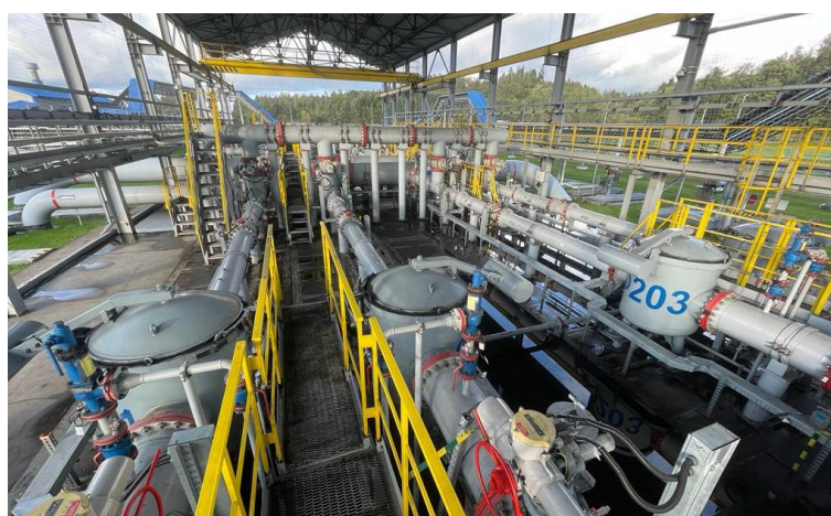
Рисунок 1 - Общий вид СИКН
